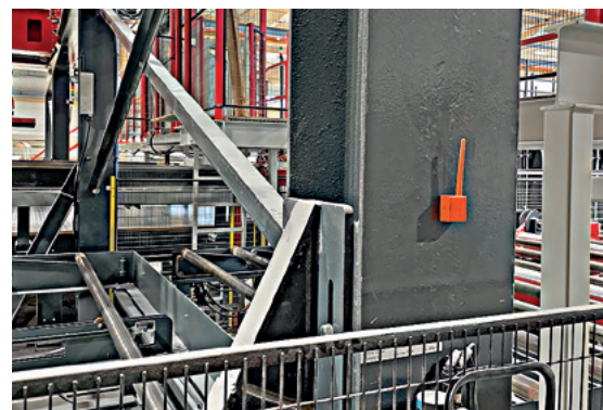
Cinq capteurs assurent la continue surveillance de température et d'humidité de l'air dans la halle de production.
